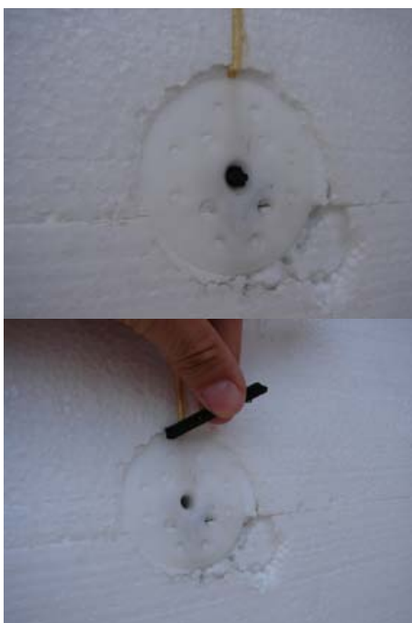
Obr. 7 Pokus o kamufláž fakticky neprovedeného kotvení
