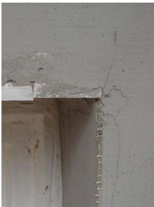
Obr. 8 Důsledky chybného vyztužení u rohů výplní otvorů
