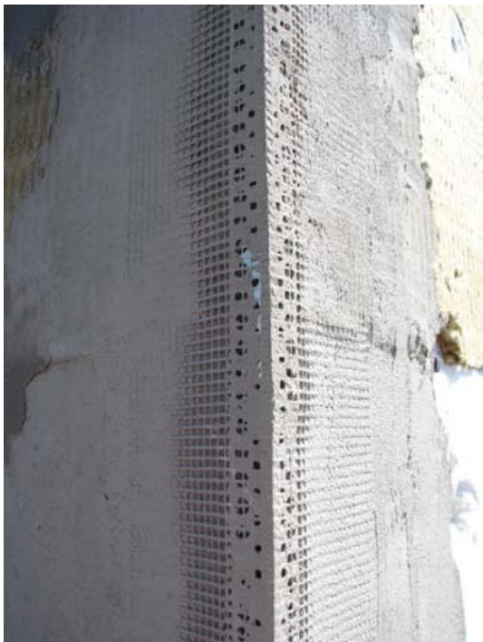
Obr. 9 Chybné osazení rohových profilů
