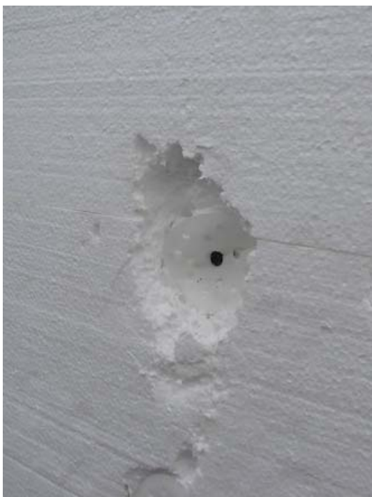
Obr. 5 Zdeformovaný a prasklý talířek, hmoždinka zapuštěna příliš hluboko do izolantu
