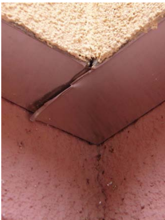
Obr. 1 Nevhodné napojení zakládacích lišt na nároží.
