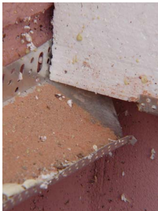
Obr. 2 Poškození zakládací lišty během zateplovacích prací.
