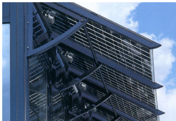
obr. 2 – FV krycí stříšky na fasádě [2]
