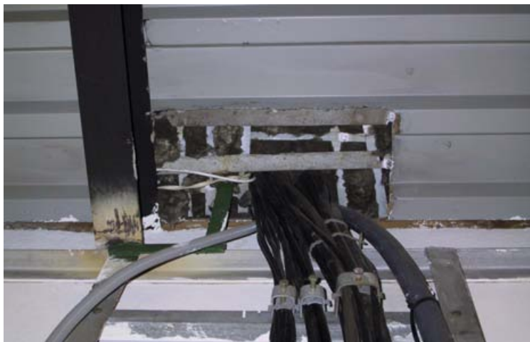
Obr.2. Nadměrně vyříznutý otvor pro prostup kabelů ocelovými stropními plechy
