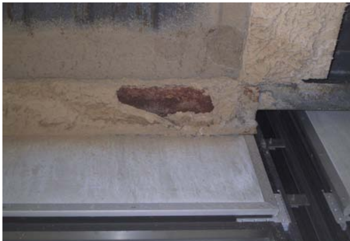
Obr.5. Odpadlý nástřik na zkorodovaném podkladu
