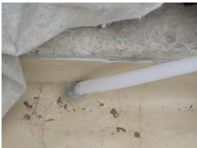
Prakticky neopracovatelný detail prostupu hydroizolací – zelená střecha
