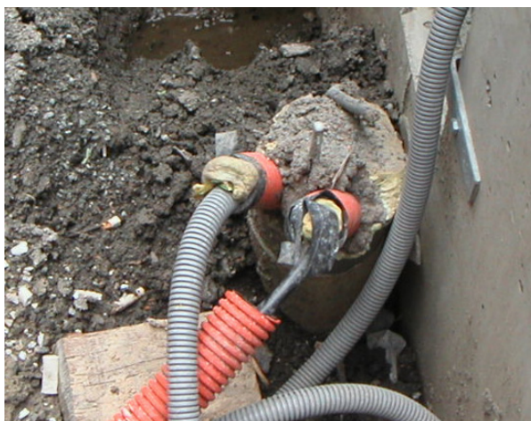
„Systémové“ utěsnění prostoru mezi průchodkou hydroizolací a prostupující instalací PUR pěnou na zelené střeše
